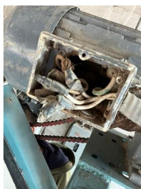
Ilustración 5.6 Motor eléctrico Fuente: Elaboración Propia.
