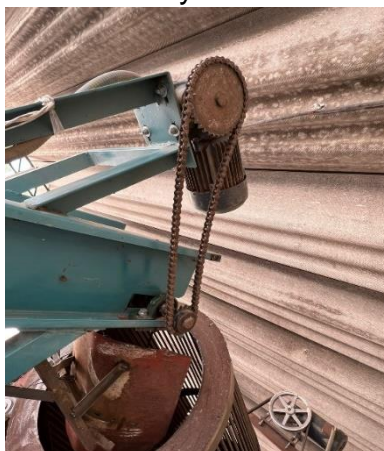
Ilustración 5.5 Motor eléctrico Fuente: Elaboración Propia.
